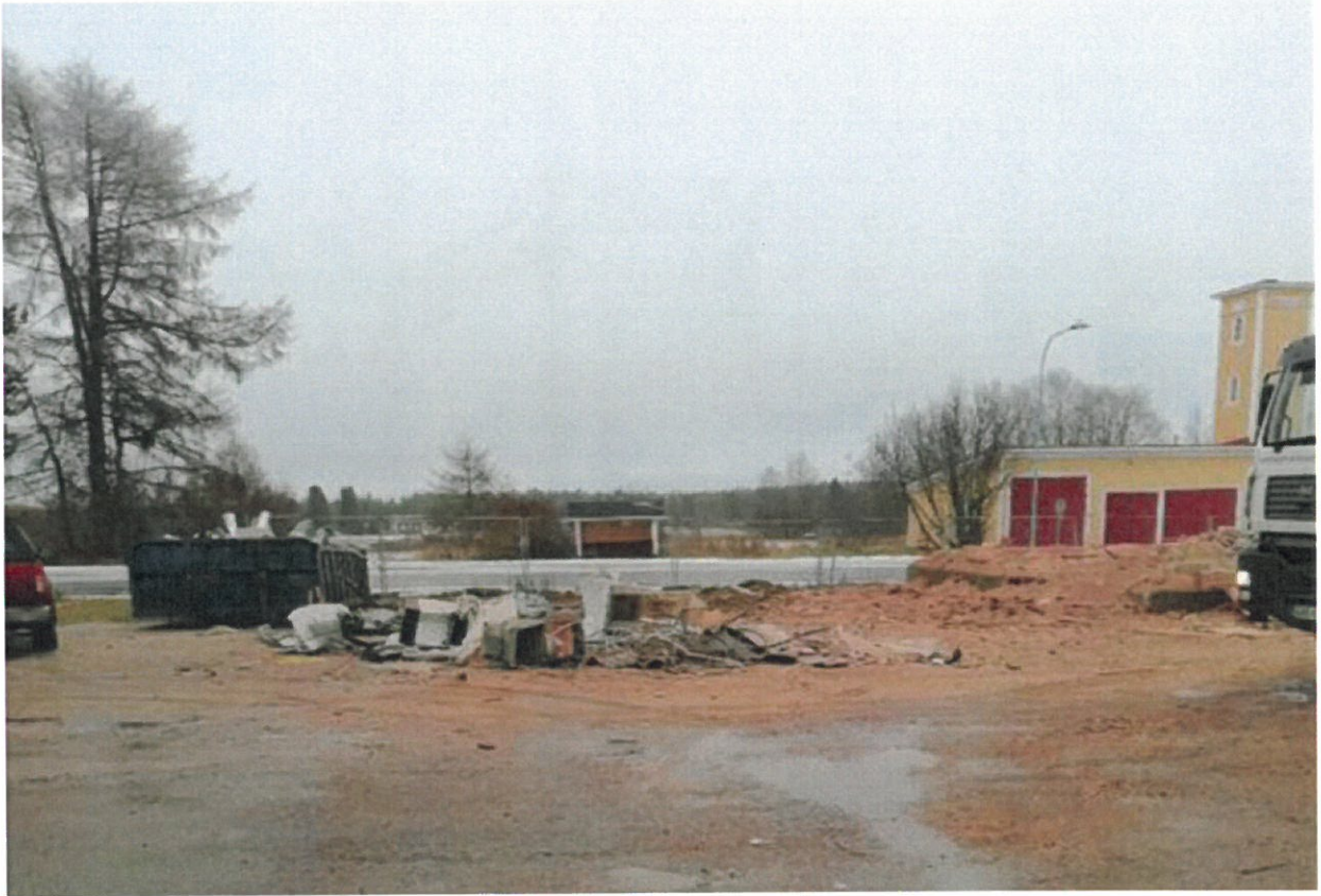
Kuva 4. Purkujätettä oli toiminnanharjoittajan mukaan siirretty kiinteistöltä Sodankyläntie 16 (583-402-38-49) jo 50-70 kuormaa, vaikka toiminta kehoitettiin lopettamaan ympäristönsuojeluviranomaisen toimesta 1.11.2022.
